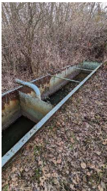
FIGURE 34 : SEPARATEUR A HYDROCARBURES EXISTANT
