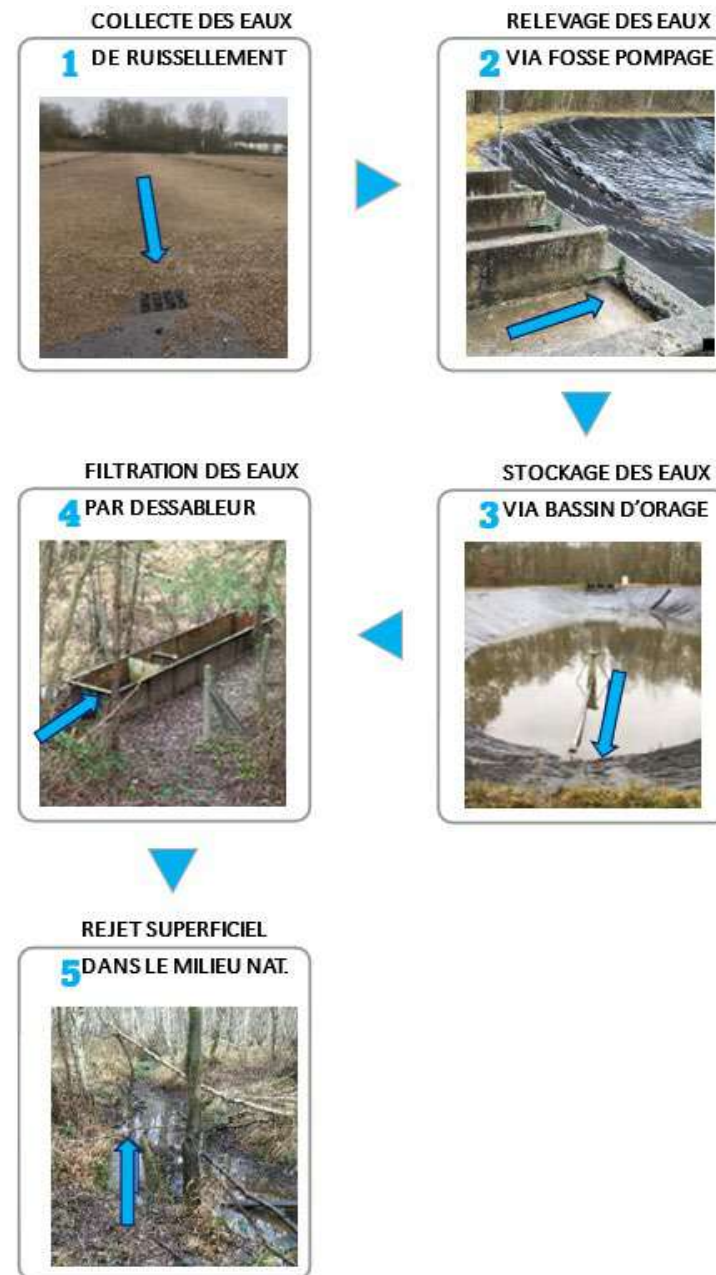
FIGURE 7 : PRINCIPE DE FONCTIONNEMENT DES BASSINS D'ORAGE (PHOTOGRAPHIES ISSUES DE L'ANTENNE DU BASSIN NORD)
